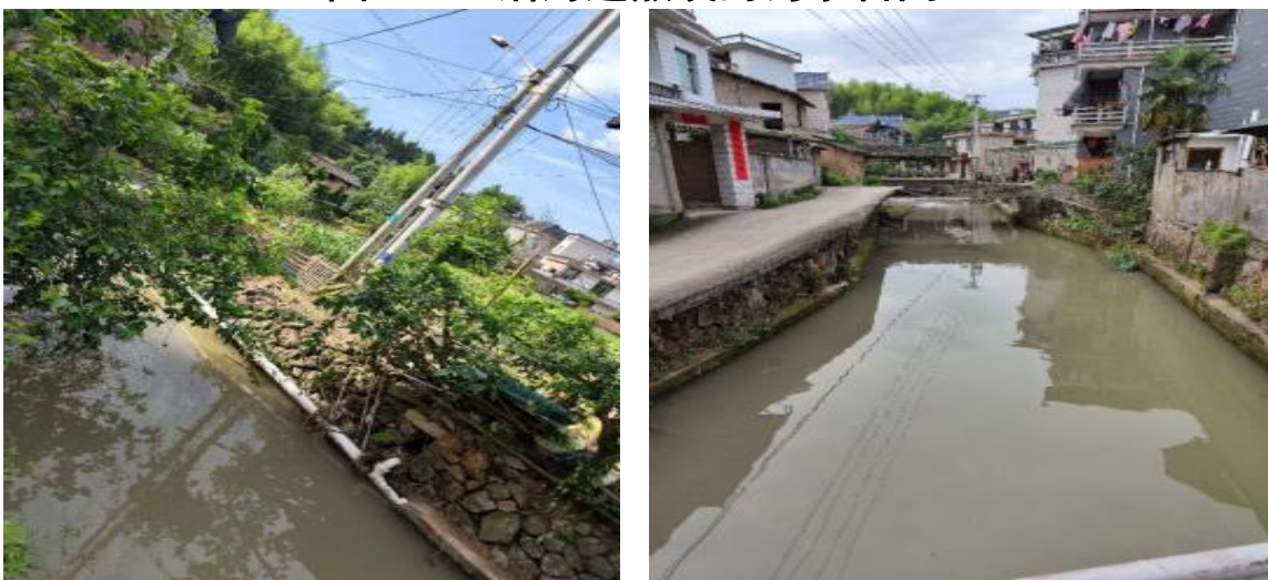
图 2.1-3 明管敷设的污水管道及管网上无检查井
